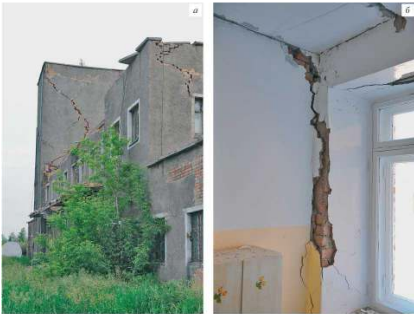
Рисунок 3.14 – Разрушения зданий при Бачатском землетрясении
